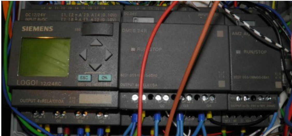
16. ábra A már beépített PLC
