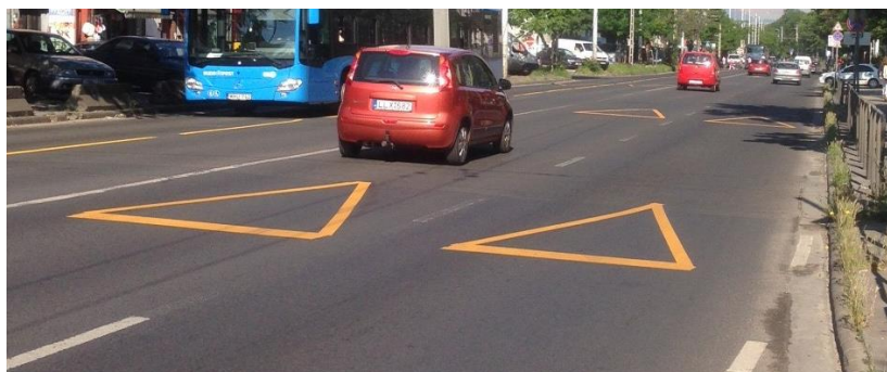
Helytelen ideiglenes útburkolati jel használata (1-es villamos felújítás, Kőbányai út)
