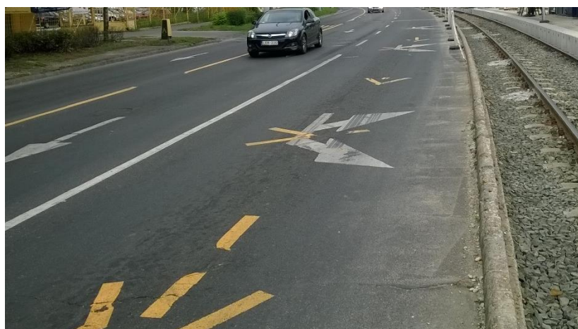
Rossz minőségű ideiglenes útburkolati jel (1-es villamos felújítás, Könyves Kálmán körút)
