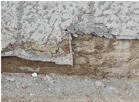
80. ábra: HIO-lemez hibás függőleges vízzárja
