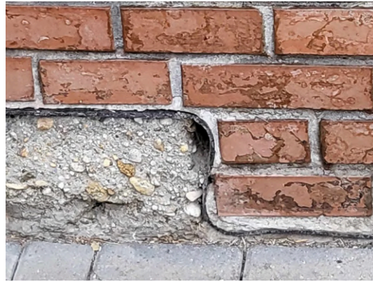
81. ábra: Résvágás hibás függőleges vízzárja
