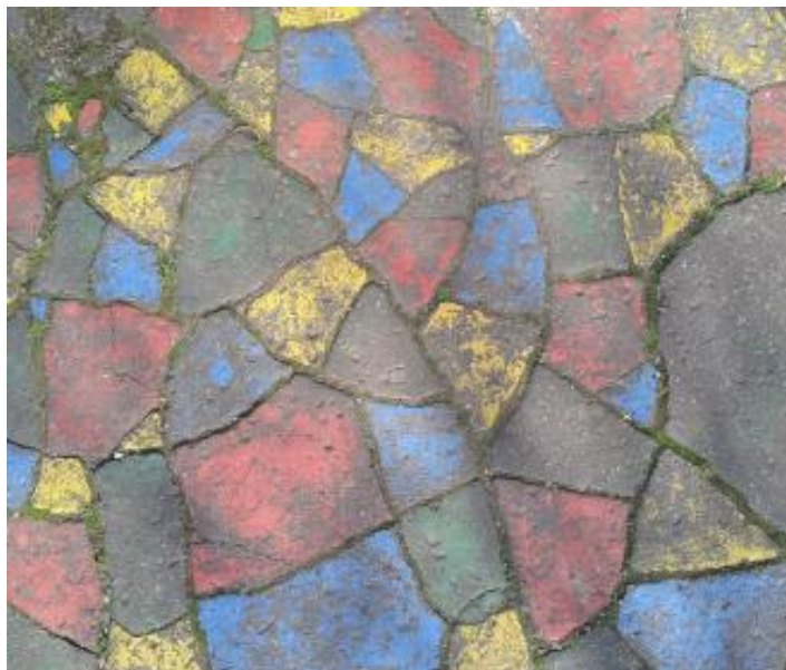
5. ábra: hosszan végigfutó repedés
