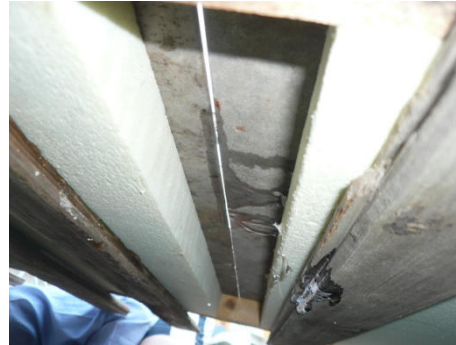
19. kép: A benedvesített alsó felületnél a vízdugó átszakadt
