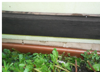
17. kép: Hátoldali fotó a tartószerkezettel az XPS tábla alsó élével és az ereszcatornával
