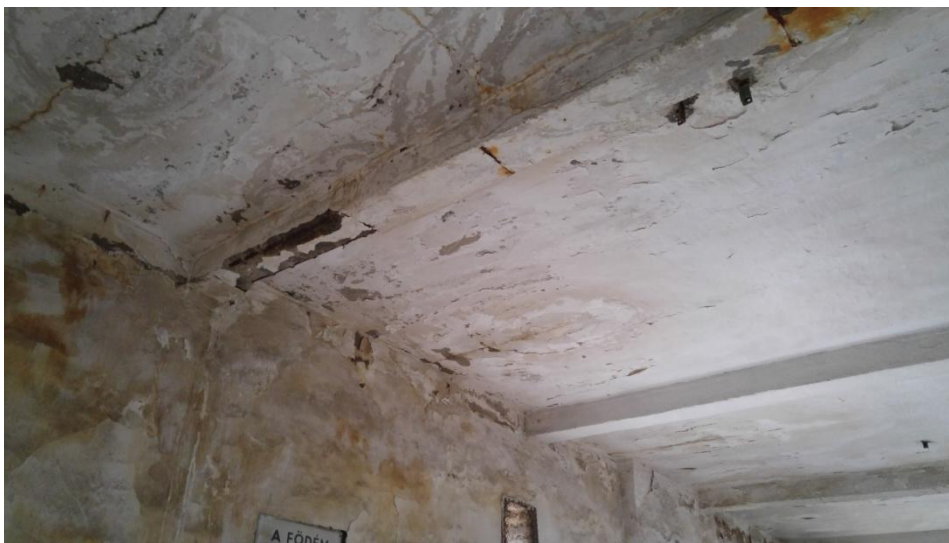
29. ábra Fal és födém beázások a 3. emelet
