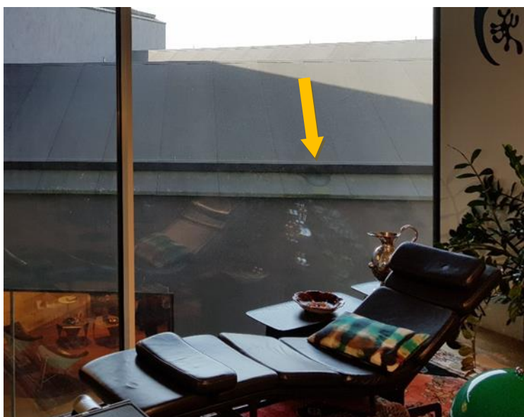
18. ábra VitraHaus eresz alatti szivárgás (képet készítette: Heincz Dániel) a szivárgás helyét sárga nyíl jelzi
