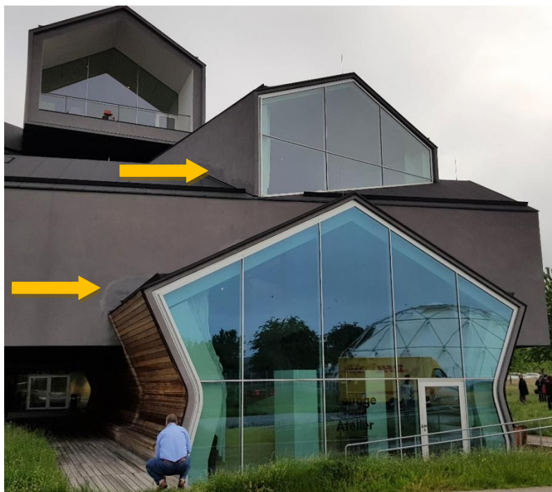
29. ábra VitraHaus, homlokzati vakolat beázásai (képet készítette: Heinz Dániel, a homlokzaton tapasztalható átázásokat nyilak jelölik)
