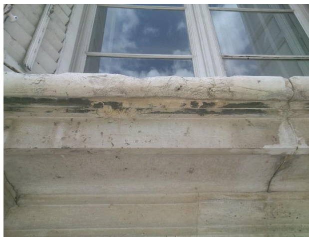
esővíz által megrongált ablakpárkány
