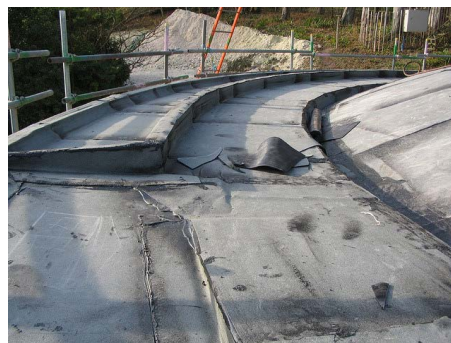
(85) Lapos ívű boltozat vízszigetelése modifikált bitumenes vastaglemezzel – épített ereszcatorna kialakítás
