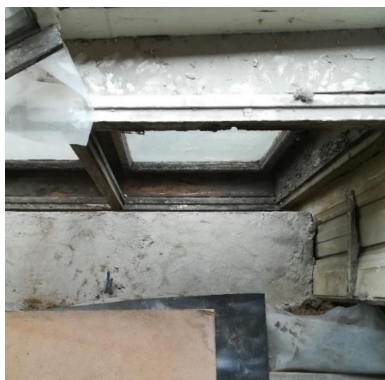
22. ábra: Az ablak a lambéria elbontása után jól látszik a középső ablakrész és a vasbeton födémlemez közötti rés. A födémeket egyszerűen nekivezették az ablaknak.
