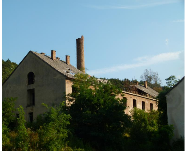
12. kép. Életveszélyes állapotú ipari épület (saját kép)
