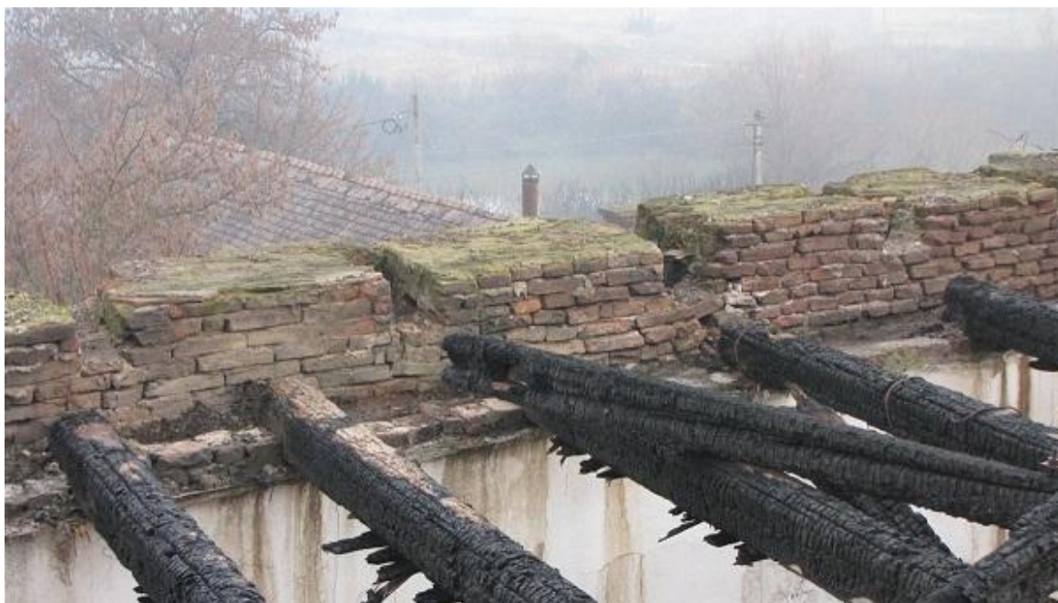
27. kép: Leégett tetőszerkezet
