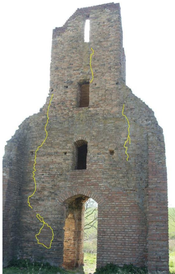
37. kép. Nyugati oldali repedések. Saját fotó és rajz
