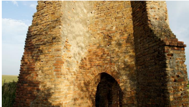
30. kép. Északi falrész az újrafalazott csúcsívvel. Saját fénykép
