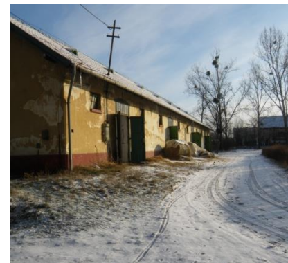
11. ábra Istállóépület - vakolatkárok (Forrás: saját felvétel)
