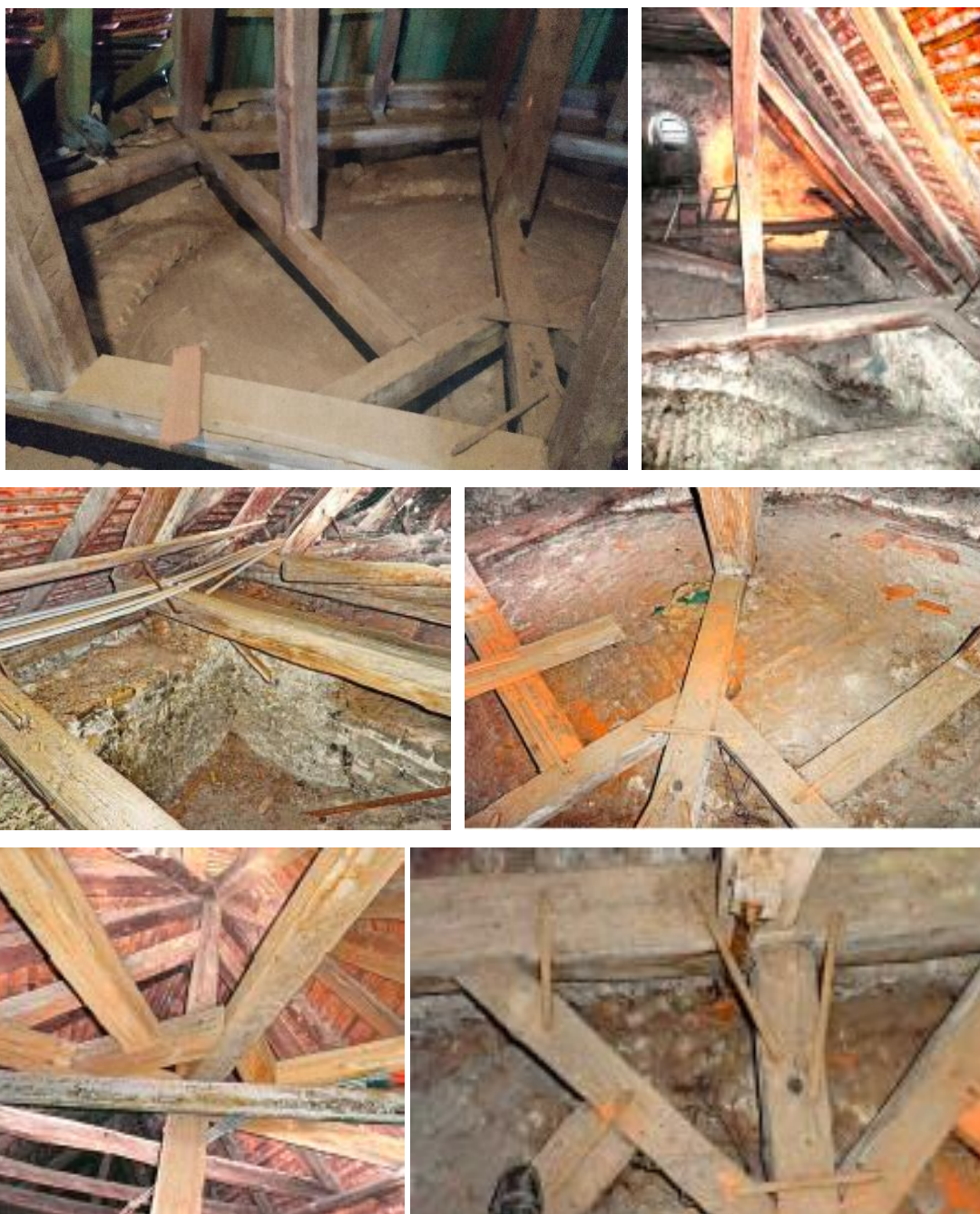
57-62. ábra: A 2016-ban készített értékleltár felvételei a tetőszerkezetről 51
