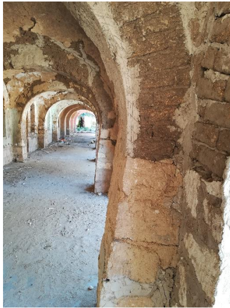
26. ábra: Kifelé dőlő pillérek, forrás: saját fotó
