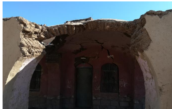
72. ábra: Beszakadt hosszirányú boltív a Khanban, forrás: saját fotó
