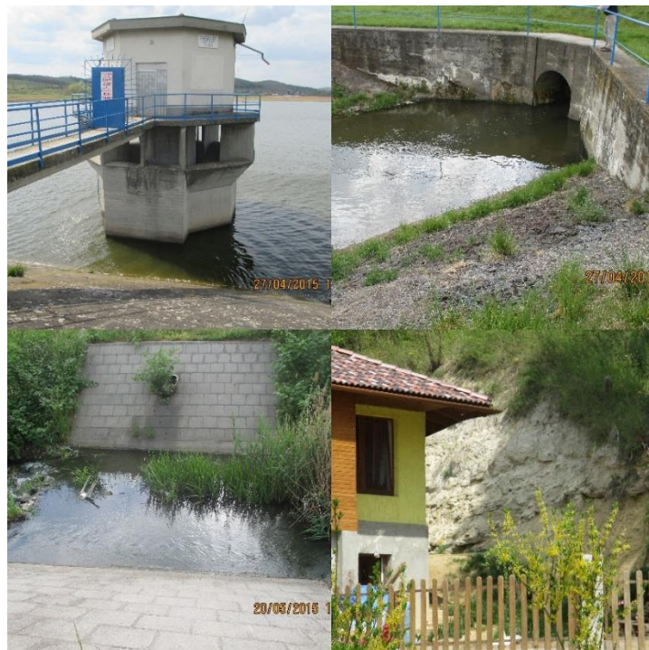
6. ábra: Felső sor: egyesített műtárgy felvízen és alvízen; alul balra: torkolat; alul jobbra: homokkő fal
