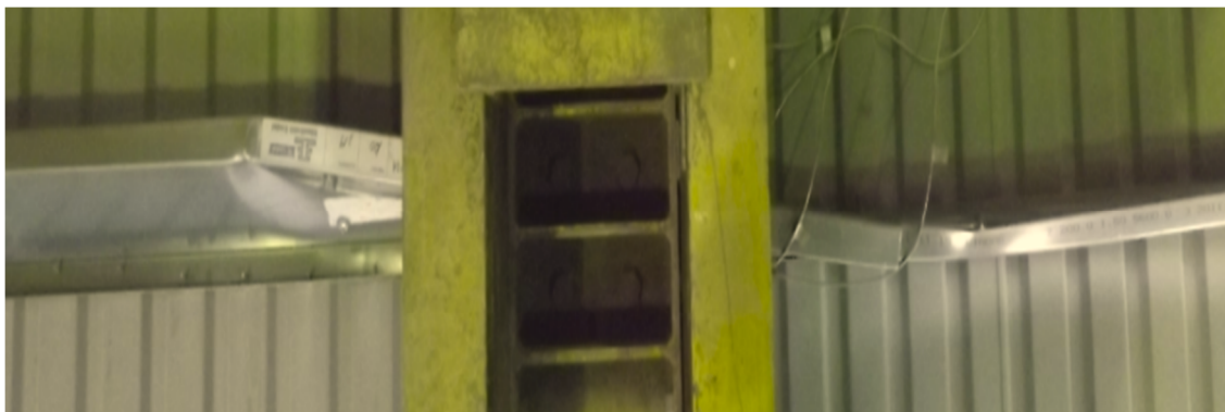
5. kép: Tönkremenetel a közbelső támasznál és a szabad öv kifordulása
