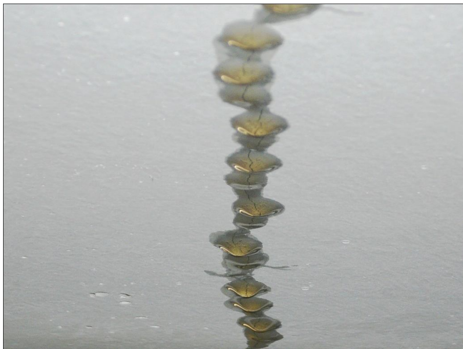
16. ábra: Födémén átmenő repedés esetén megjelenő átázás
