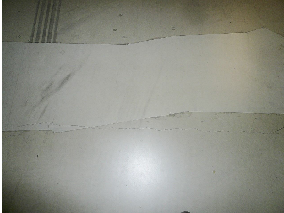
17. ábra: Javítás után újból megjelenő repedés
