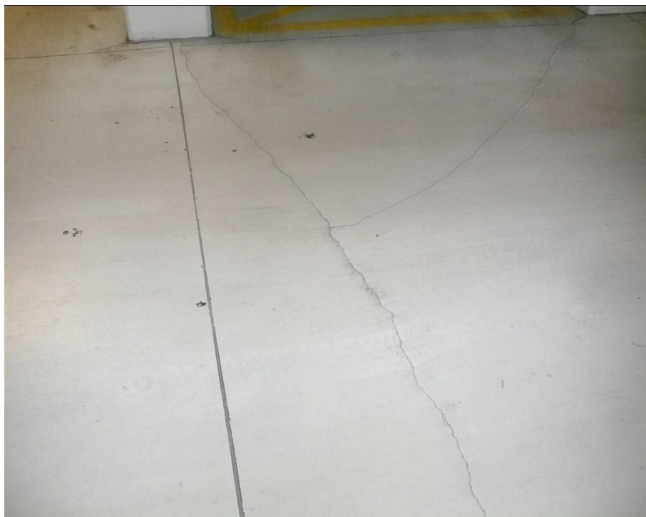
15. ábra: Zsugorodásból származó repedések egy mélygarázs földemen
