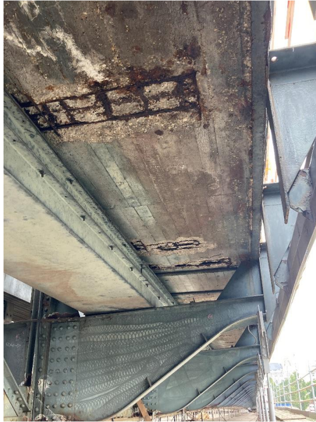
4.3. ábra: Korrózió a járdalemezen.
