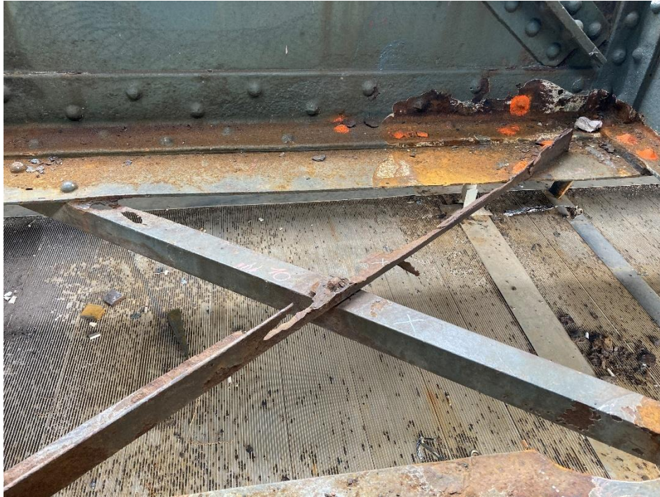
4.5. ábra. Szinte teljes keresztmetszetben korrodálódott szélrács a merevítőtartóban.
