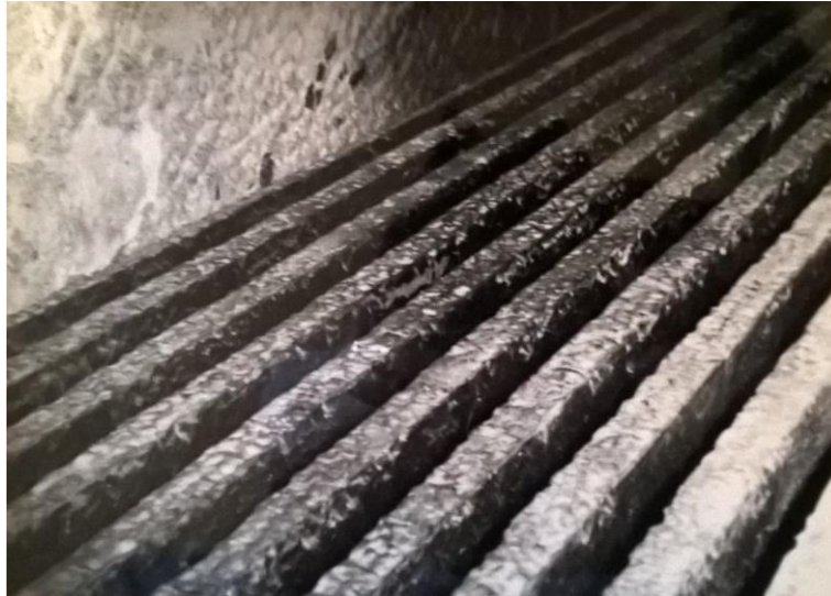
4.1. ábra: Helyszíni fotó egy korrodált lánckötegről [1].
