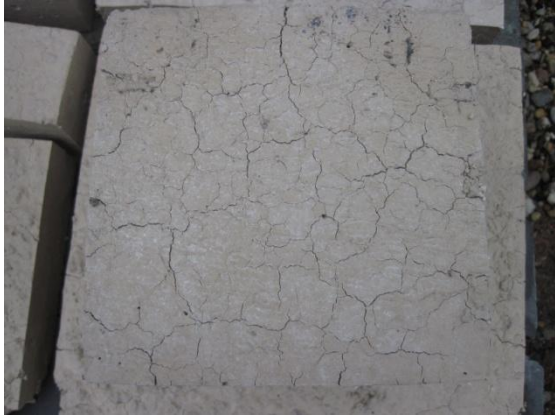
38. ábra – Pókhálós repedéshálózat
