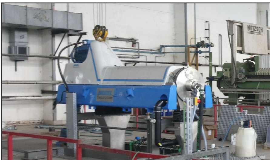
17. ábra - Iszapvíztelenítő centrifuga az Észak-pesti Szennyvíztisztító Telepen Forrás: Fővárosi Csatornázási Művek Zrt.
