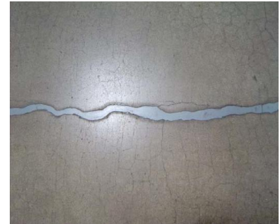
c) átmenő repedés
