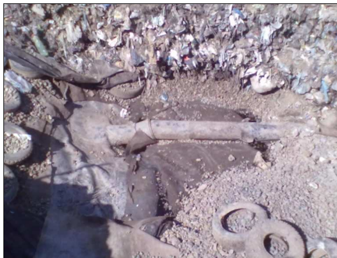
2.1. ábra. Sérült aljzatszigetelés (Hejőpapi)
