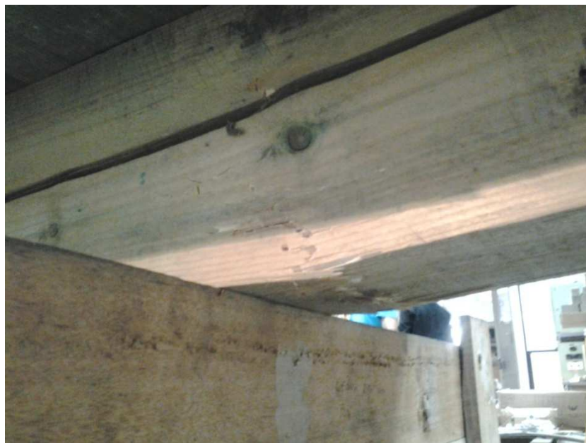
17. ábra A tönkrement szélső, húzott öv
