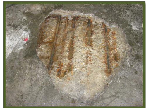
2. ábra: Karbonátosodás következtében korrodálódott vasbeton
