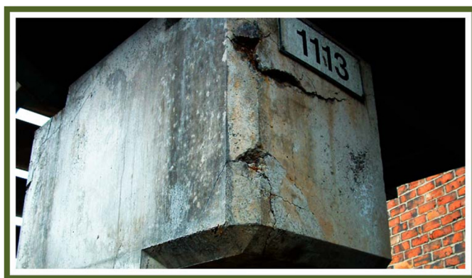
8. ábra: Kloridok által okozott korrózió eredménye
