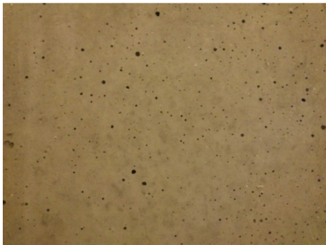
2-23. ábra: Porózus betonfelület
