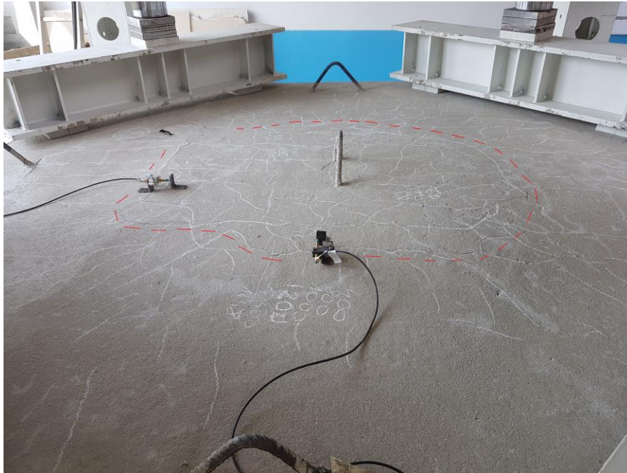
30. ábra: Átszűrődési kúp a 15. jelű próbatesten (a kúp körvonalát a piros szaggatott vonal jelzi)
