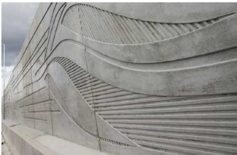
31. ábra - Speciális beton anyagú zajvédő fal, mely egyben az út biztonsági elemét is képezi (Auckland, NZ) [7]
