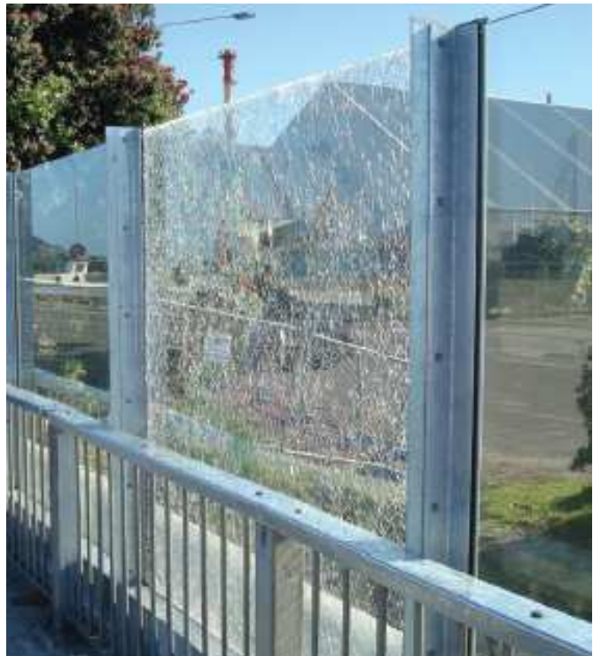
28. ábra - Átlátszó üvegpanel esetén figyelembe kell venni a panelelem fokozott sérülékenységét [7]
