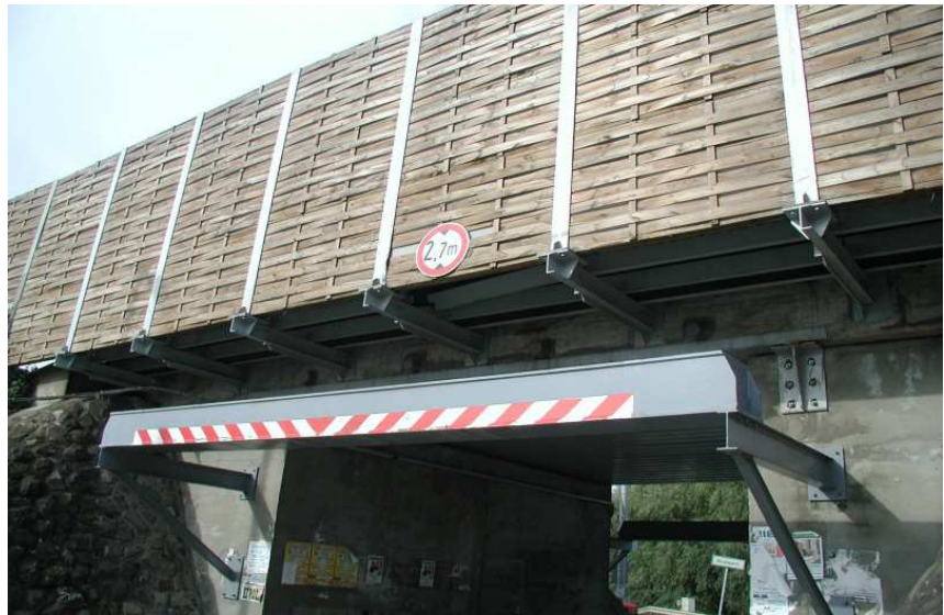
32. ábra - Fonott faanyagú zajvédő fal – műtárgyon [29]
