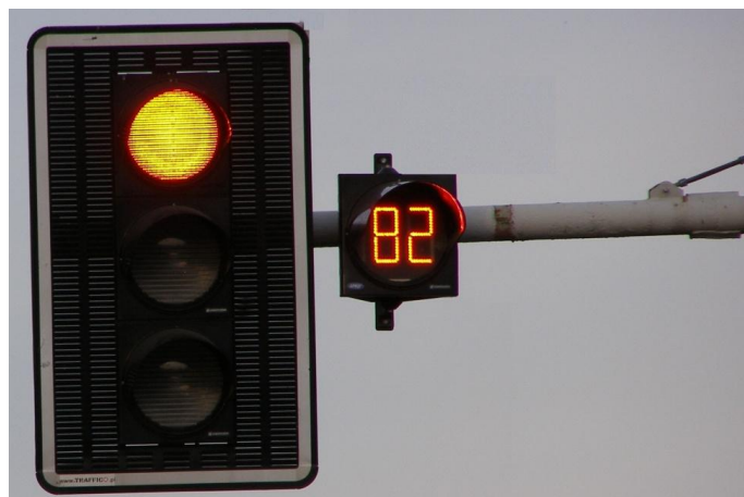
28. ábra: A visszaszámláló berendezéssel ellátott jelzőlámpa. (Kép forrása: Horváth Ádám András)
