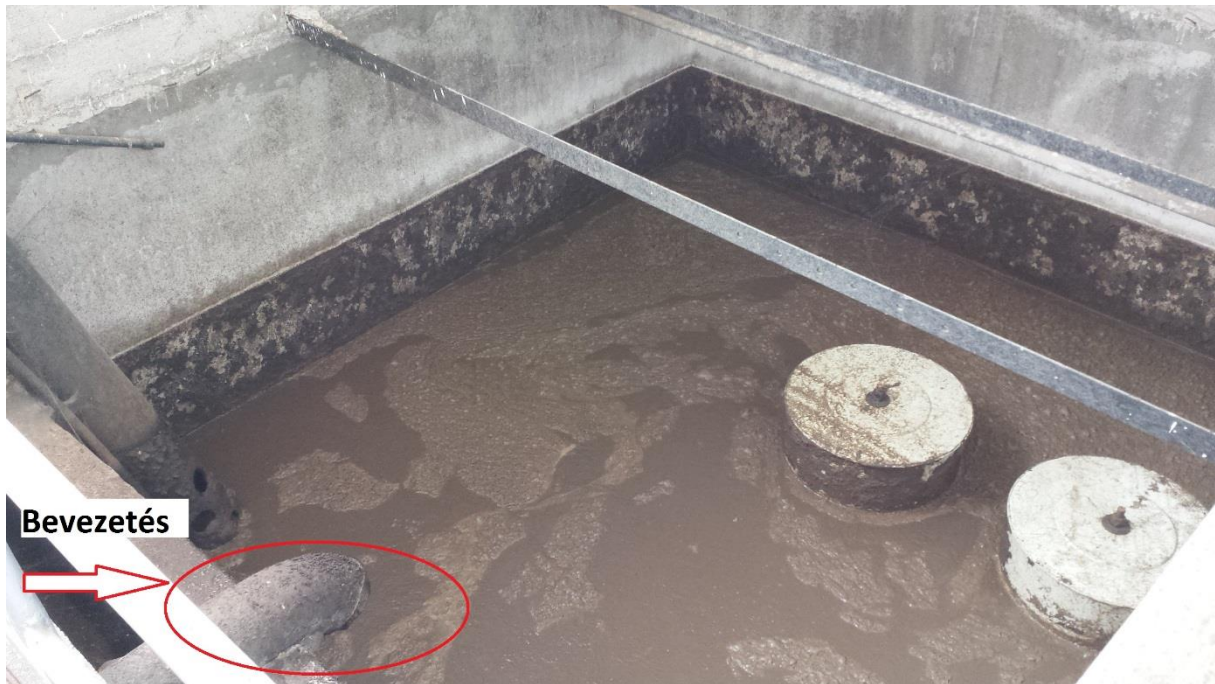
9. kép: Iszapsűrítő régi bevezetése
